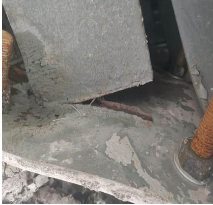
图 7 钢柱与柱脚底板焊接破坏
