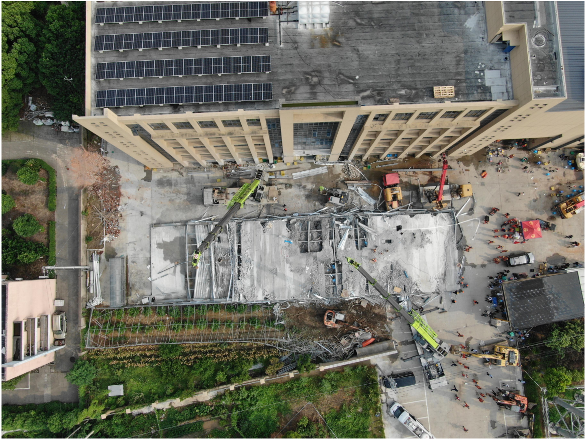
图3 6#厂房整体坍塌现场图
