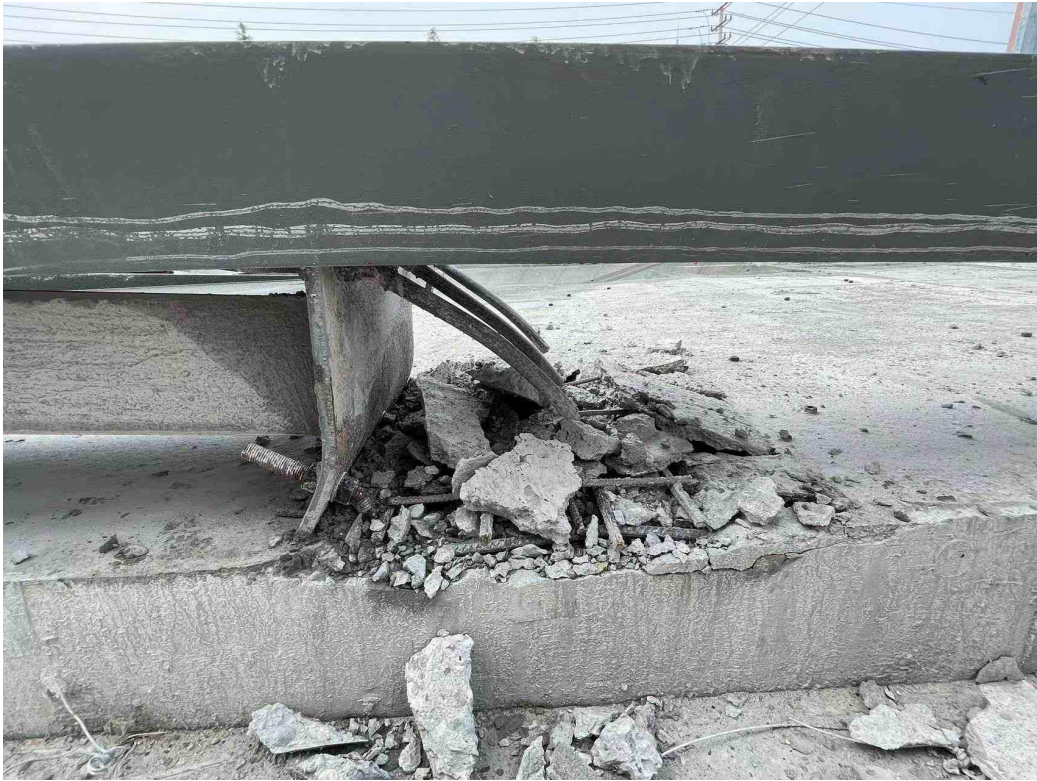
图 5 钢柱失稳破坏
