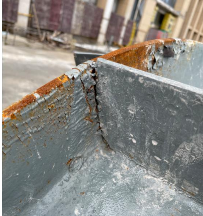
图9 焊脚尺寸不足、焊缝不饱满
